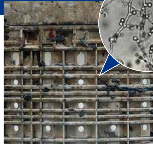
カビが繁殖した洗濯槽の裏側
